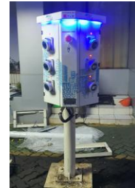
SPKLU R2 UP3 Bulungan 6 slot (3500 watt per slot)
